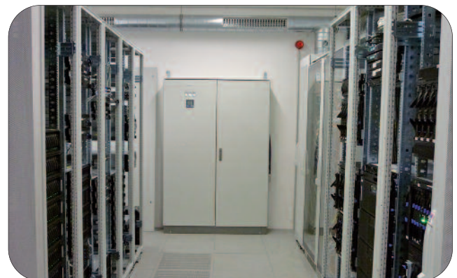
Server-Raum Kommunale Datenzentrale
